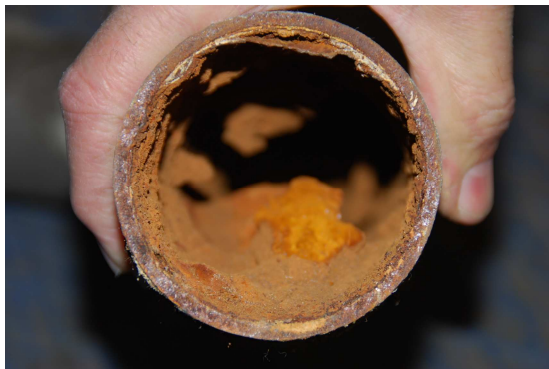
Abbildung einer Frischwasserleitung
