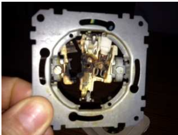
Abbildung einer defekten Steckdose Bauteil C
