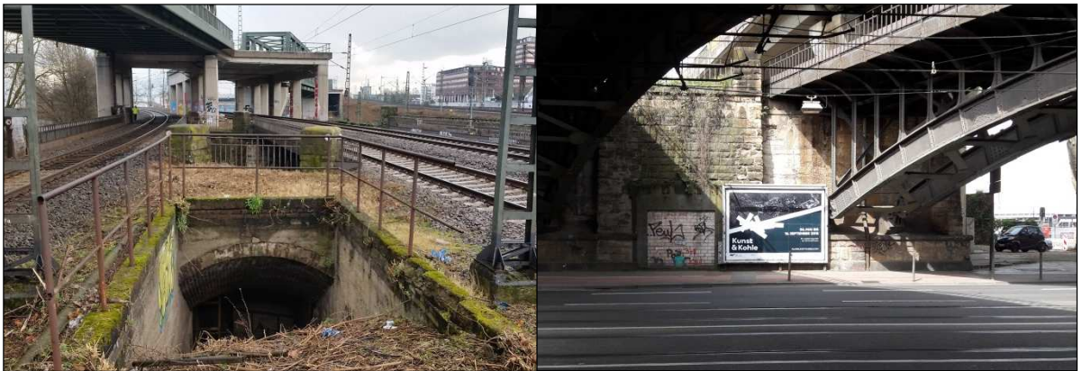
Abbildung 5: Fotos „alter“ verschlossener Treppenaufgang zwischen BWD und E
